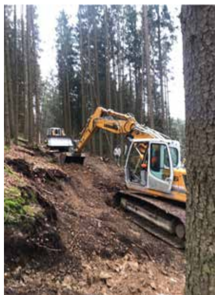
Professioneller Wegebau auch im Privatwald sinnvoll (hier Erschließung eines Hanges im Bereich der FBG mit ca. 4 ha mit einer Weeglänge von ca. 1100 m)
